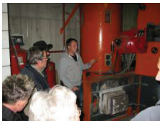
Michel Wirth erläutert die neue Heizzentrale, die eine Anzahl Gebäude im Altbachs beheizt.
