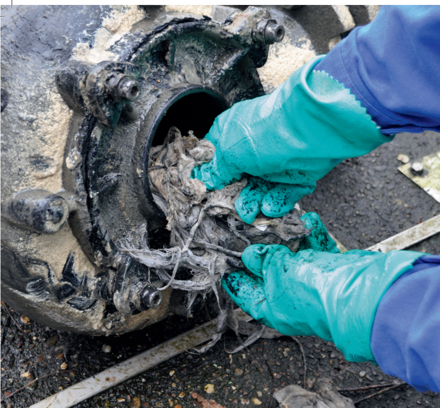
Verstopfte Pumpen, aufwändige Instandstellung.
